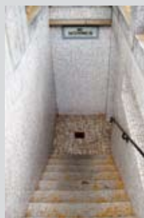
Toilettes inaccessibles à cause des marches.
